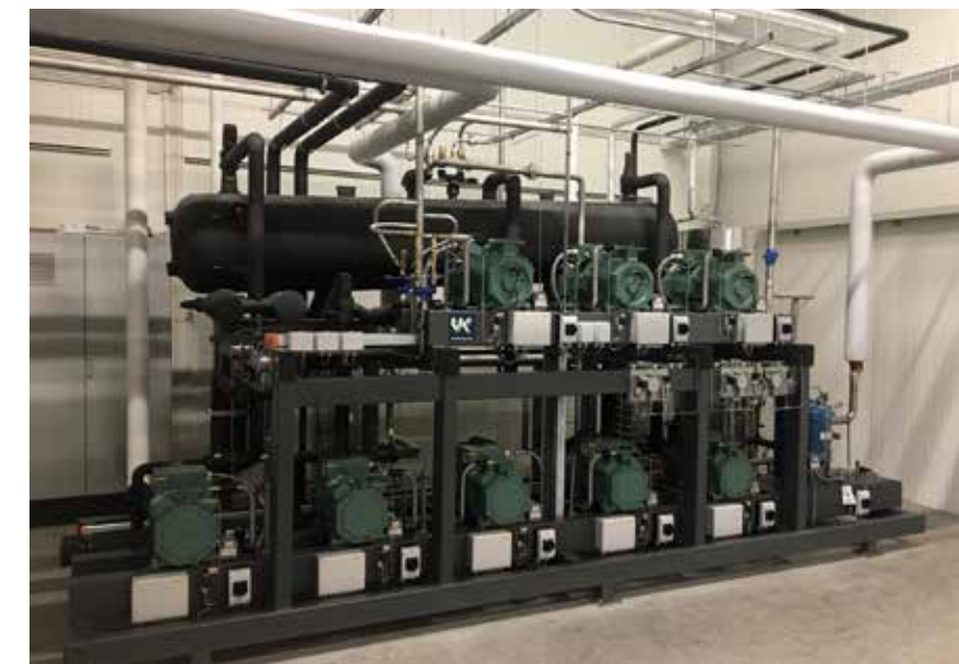
Klant Kippie, centrale CO 2 koel- en vriesinstallatie voor diverse kipproducten.
